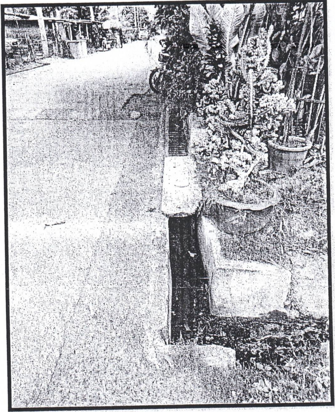
ภาพถ่ายระบบระบายน้ำบ้านพักอาศัยและถนนภายในบ้านพักอาศัย
