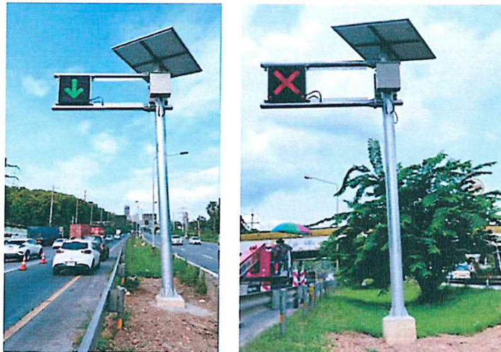
รูปที่ ๕.๑ แสดงระบบแจ้งเตือนการเปลี่ยนทิศทางการเดินทางรถสำหรับการ เปิด - ปิด ช่องทางพิเศษ
