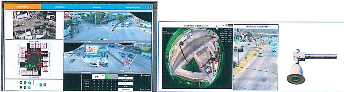
รูปที่ ๑๒.๑ แสดงระบบควบคุมไฟสัญญาณจราจรชนิด Adaptive Traffic Signal Control
